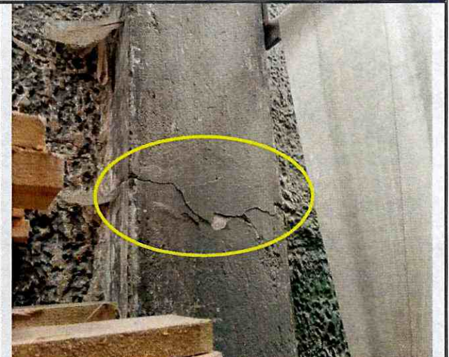
Fotografía 4. Fractura en una de las columnas perteneciente al muro de aislamiento de la zona posterior de la empresa WESCO S.A.
