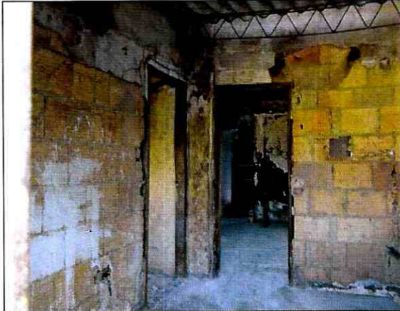
Fotografía 3. Vista de espacio interior del 3 nivel, donde se observa daños en muros y cubierta.
