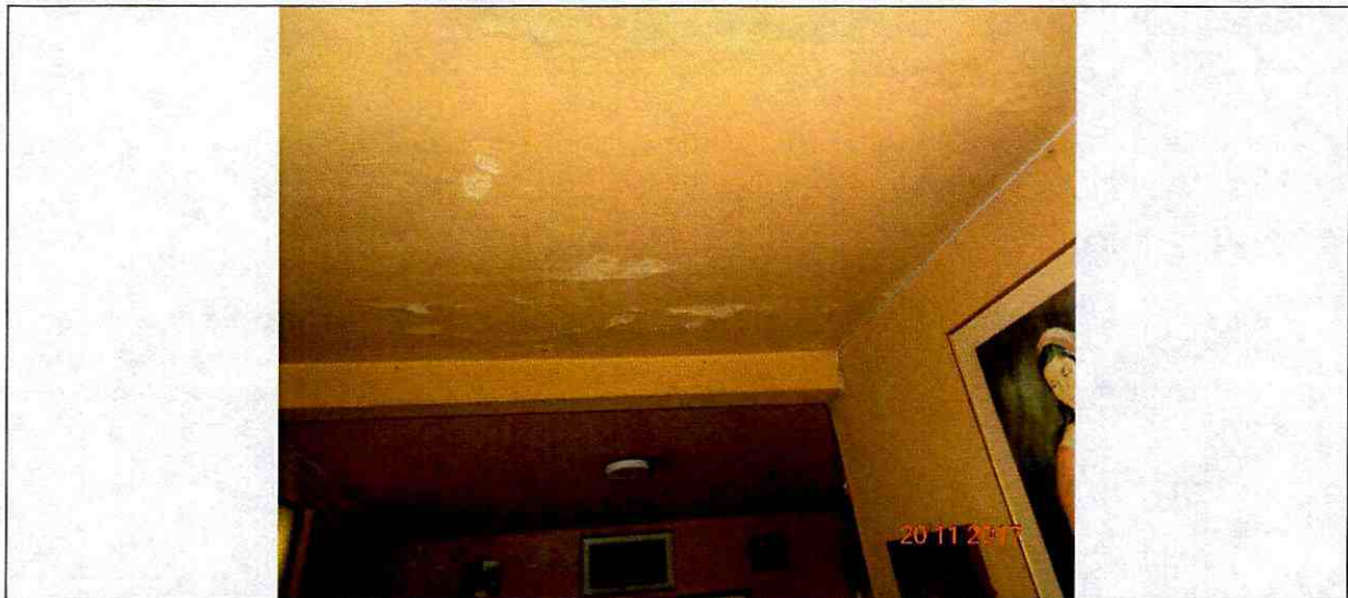
Fotografía 1: Se observa las humedades que se presenta en la placa de entrepiso hacia el costado occidental.
