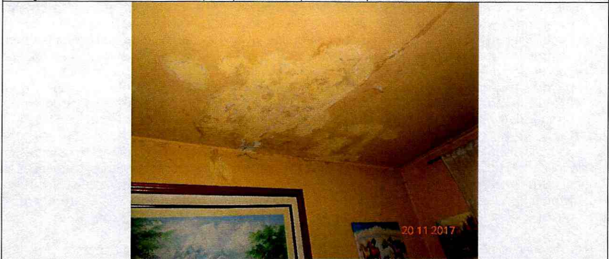
Fotografía 2: Se observa las humedades que se presenta en la placa de entrepiso hacia el costado occidental.
