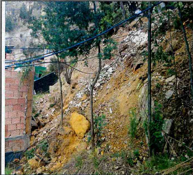
Fotografía 5. Desprendimientos de material rocoso desde la ladera ubicada al costado oriental de las dos viviendas ubicadas en el punto con coordenadas de localización Punto 2 X:106505.28 Y:115831.59
