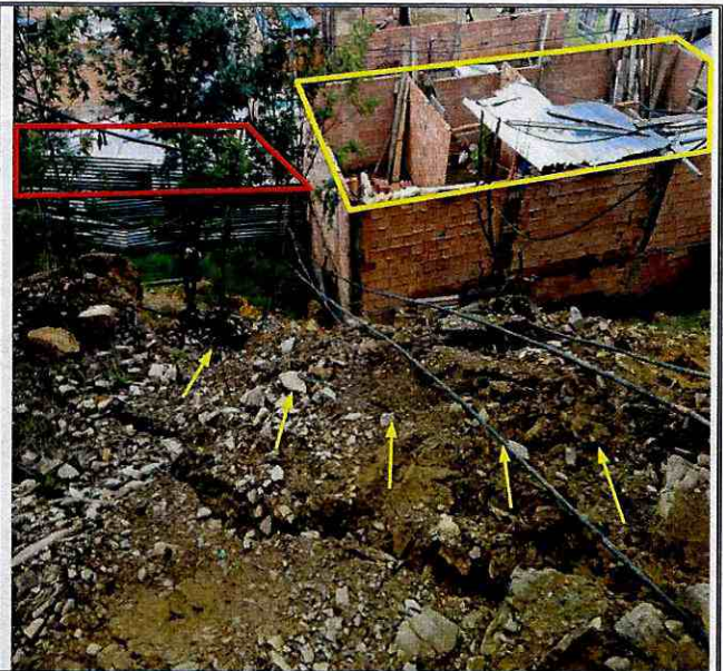
Fotografía 6. Viviendas ubicadas en la parte alta de la ladera en el punto con coordenadas de localización Punto 2 X:106505.28 Y:115831.59, expuestas al movimiento en masa identificado en la zona. Se observan las grietas de tracción.
