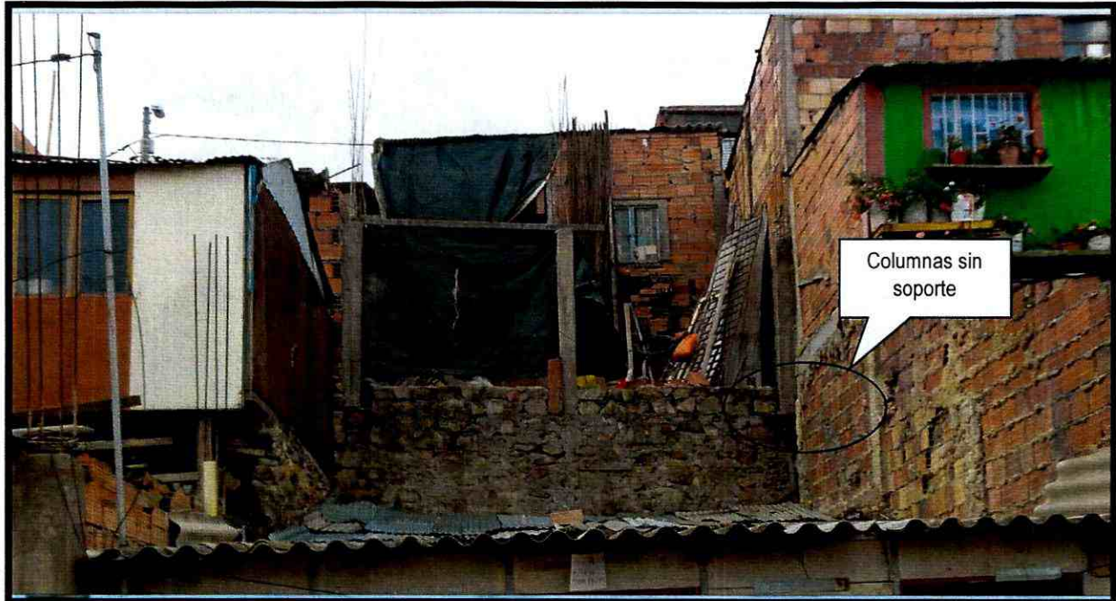
Fotografía 4. Columnas sin soporte en la base en el patio posterior del predio de la señora Rodríguez en el Sector El Mirador II de la Localidad de Ciudad Bolívar
