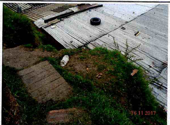
Foto No. 4. Terreno inestable
