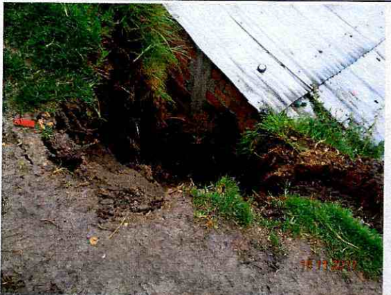
Foto No. 3. Material depositado en la parte baja. Muros perimetrales de la vivienda de la Calle 82 D Sur No. 18N-10
