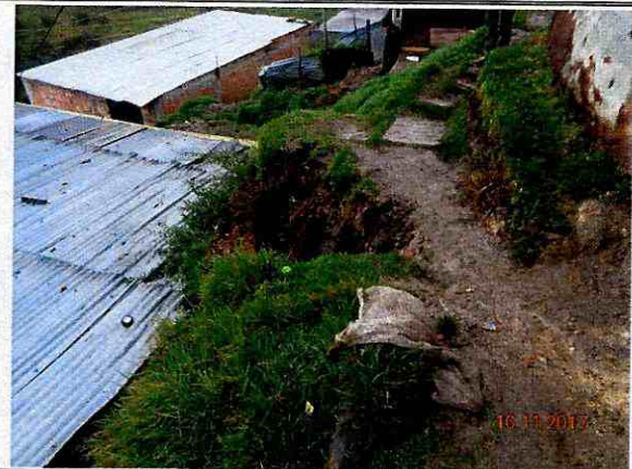
Foto No. 2. Movimiento en masa talud de corte predio de la Calle 82 C Sur No. 18N-19
