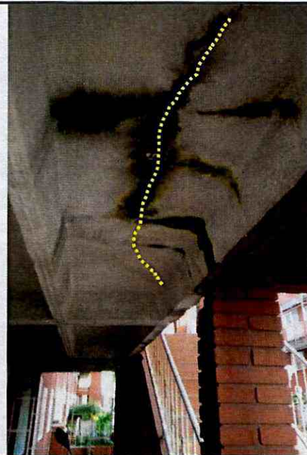
Fotografía 8. Fracturas en la loseta superior de uno de los pasillos de acceso a los apartamentos superiores de los bloques de apartamentos ubicados en el predio de la Calle 82 B No. 94 L – 30, en el Sector Catastral Bachue de la Localidad Engativá.
