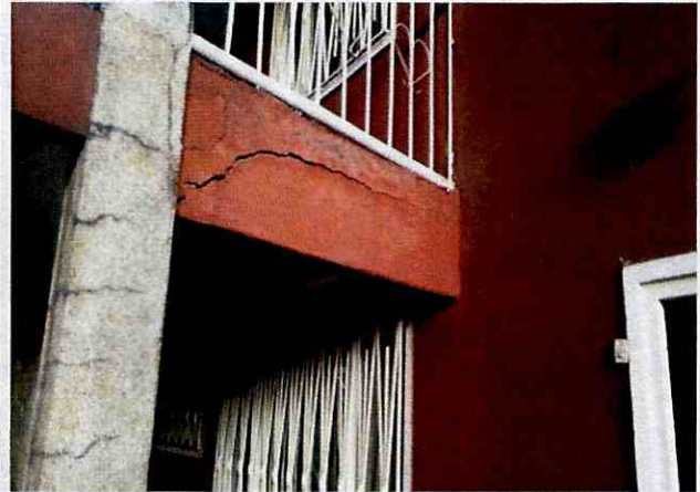
Fotografía 6. Daños identificados en las escaleras de acceso a los apartamentos superiores y en los voladizos que sirven de pasillo en el predio de la Calle 82 B No. 94 L – 30, en el Sector Catastral Bachue de la Localidad Engativá.
