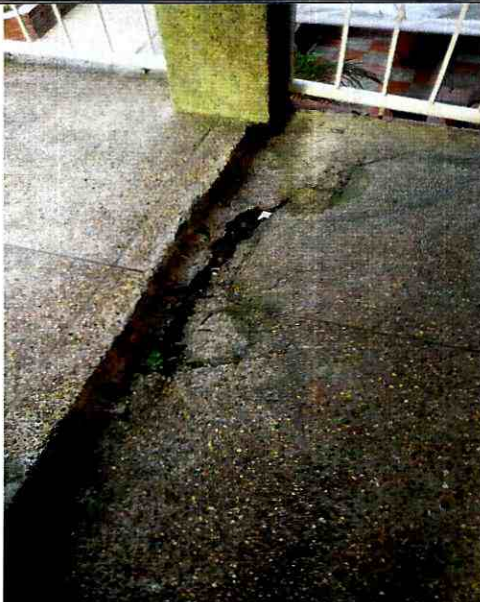
Fotografía 11. Desnivel entre una de las escaleras y el voladizo que sirve de pasillo de acceso a los apartamentos superiores de los bloques de apartamentos ubicados en el predio de la Calle 82 B No. 94 L – 30, en el Sector Catastral Bachue de la Localidad Engativá.
