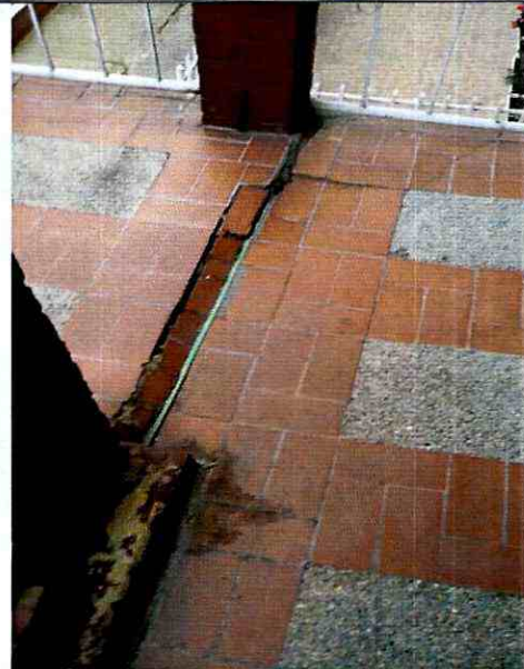
Fotografía 12. Desnivel entre una de las escaleras y el voladizo que sirve de pasillo de acceso a los apartamentos superiores de los bloques de apartamentos ubicados en el predio de la Calle 82 B No. 94 L – 30, en el Sector Catastral Bachue de la Localidad Engativá.
