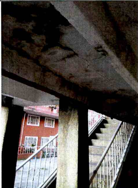
Fotografía 9. Separación entre la viguetería y la loseta que conforma uno de los pasillos acceso a los apartamentos superiores de los bloques de apartamentos ubicados en el predio de la Calle 82 B No. 94 L – 30, en el Sector Catastral Bachue de la Localidad Engativá.
