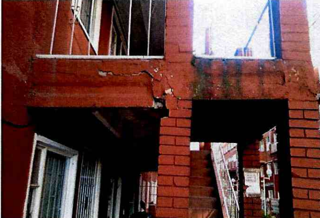
Fotografía 5. Daños identificados en las escaleras de acceso a los apartamentos superiores y en los voladizos que sirven de pasillo en el predio de la Calle 82 B No. 94 L – 30, en el Sector Catastral Bachue de la Localidad Engativá.
