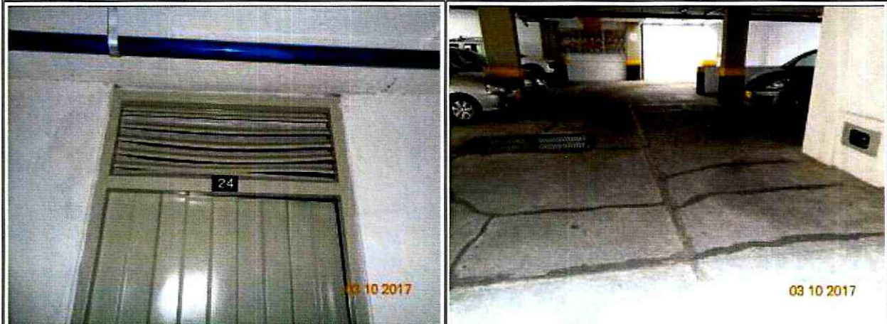
Foto No. 4 y 5. Desajuste de puertas y grietas en losa de contrapiso sector del Sótano
