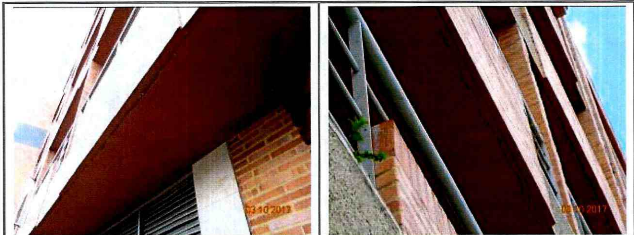
Foto No. 14 y 15. Dilataciones elementos de fachada
