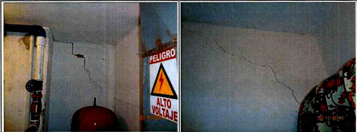
Foto No. 2 y 3. Grietas en muros del cuarto de bombas sector del solano del Edificio Multifamiliar Agua
