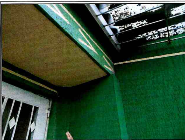
Fotos 2. Vista de los daños que presenta la vivienda evaluada.
