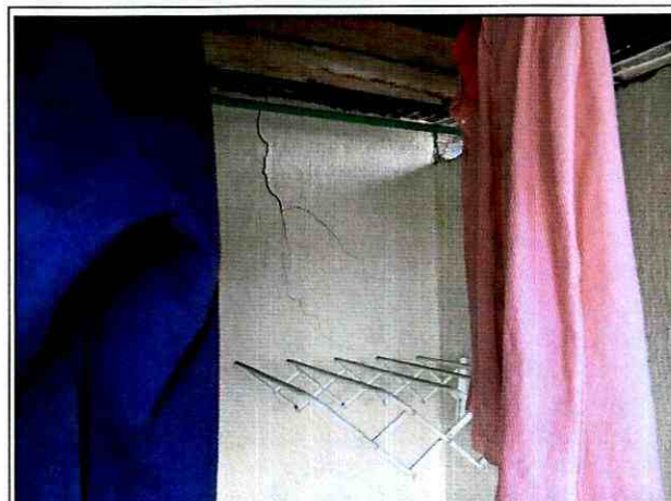
Fotos 3 y 4. Vista de los daños que presenta la vivienda evaluada.
