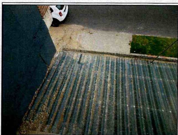
Foto 7. Vista de los daños que presenta la vivienda evaluada.
