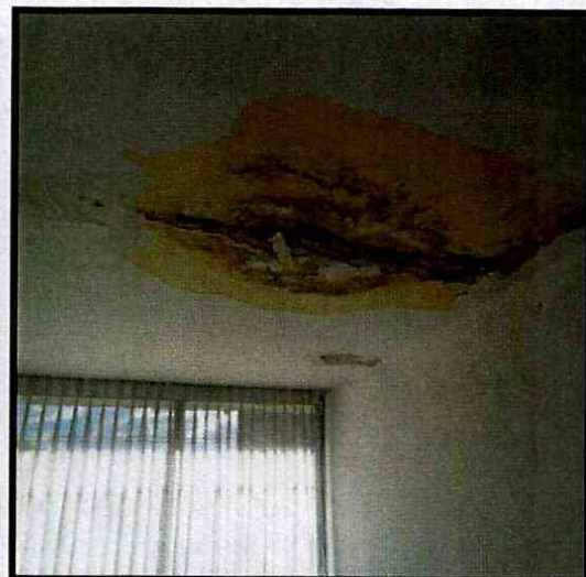
Fotografía 2. Apariencia del cielorraso en la habitación del costado occidental del apartamento 501 el día 13 de Octubre de 2017
