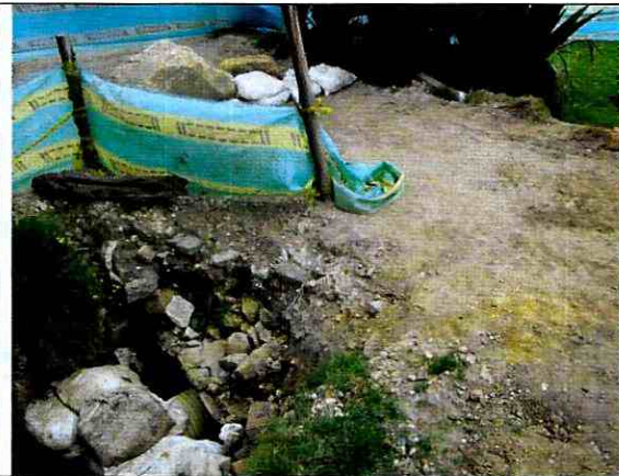
Fotografía 2. Vista de la superficie de rodadura del “puente” ubicado en el sector evaluado.
