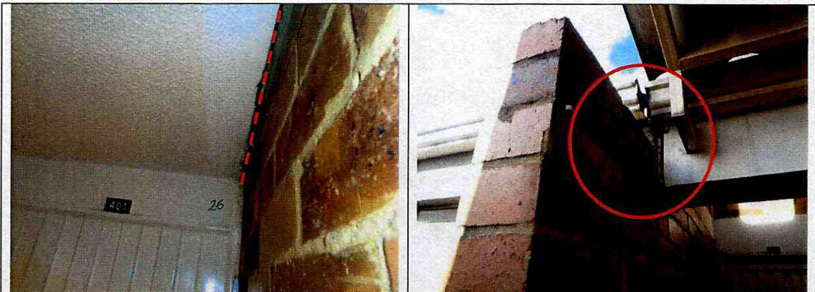
Fotografía 7. Fisuras evidenciadas en las zonas comunes del interior 8, apto 401 el numero indica el identificador dado a la estructura para realizar el seguimiento
