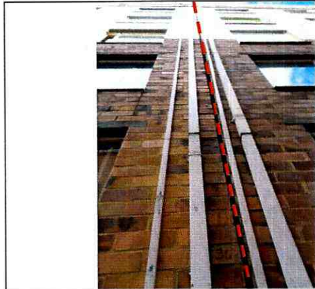
Fotografía 9. Condición actual y detalle del exterior del interior 8 del Conjunto Residencial Parques de Galicia, se observa la separación en la junta de construcción aproximadamente 4cm. (Visita de Septiembre de 2017)
