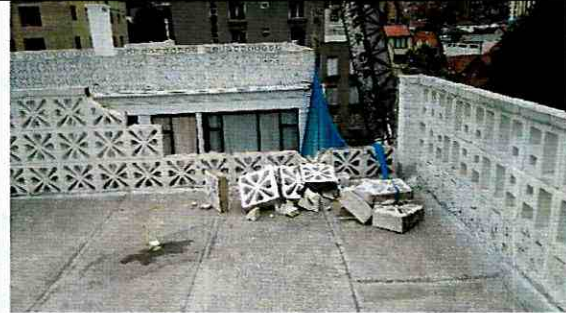
Fotografía 2. Vista de los daños ocasionados en la terraza del predio con dirección Carrera 19 No. 33 A – 75, en el Sector Catastral Teusaquillo de la Localidad de Teusaquillo.
