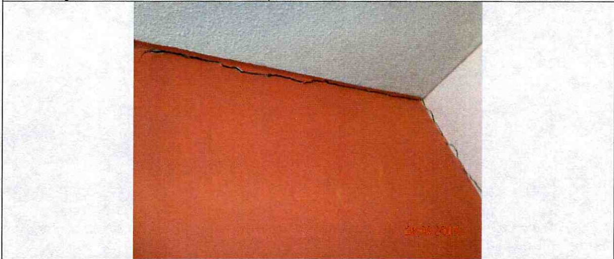
Fotografía 3: Daños evidenciados al interior del predio de la Calle 99 N° 49-41, en la Localidad de Barrios Unidos.
