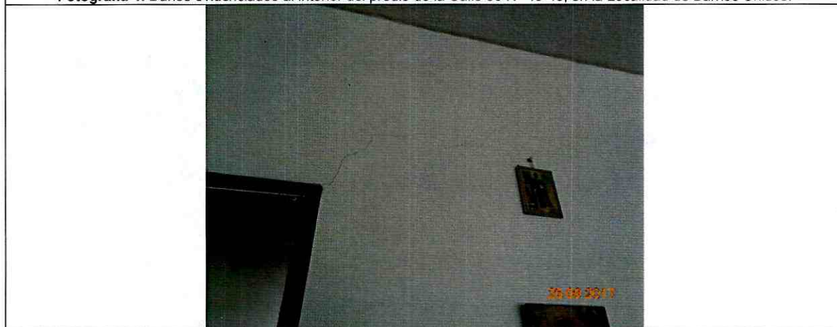
Fotografía 5: Daños evidenciados al interior del predio de la Calle 99 N° 49-45, en la Localidad de Barrios Unidos
