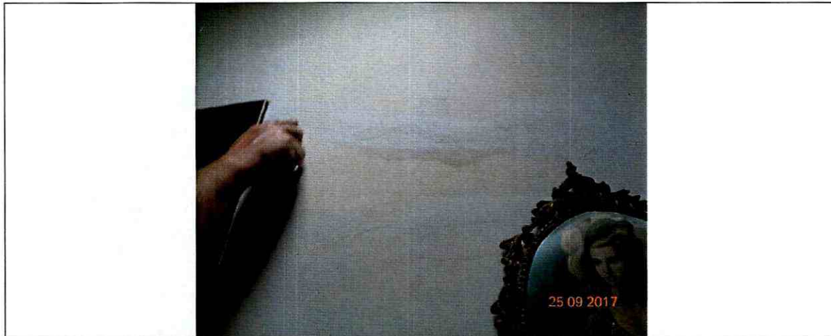
Fotografía 4: Daños evidenciados al interior del predio de la Calle 99 N° 49-45, en la Localidad de Barrios Unidos.
