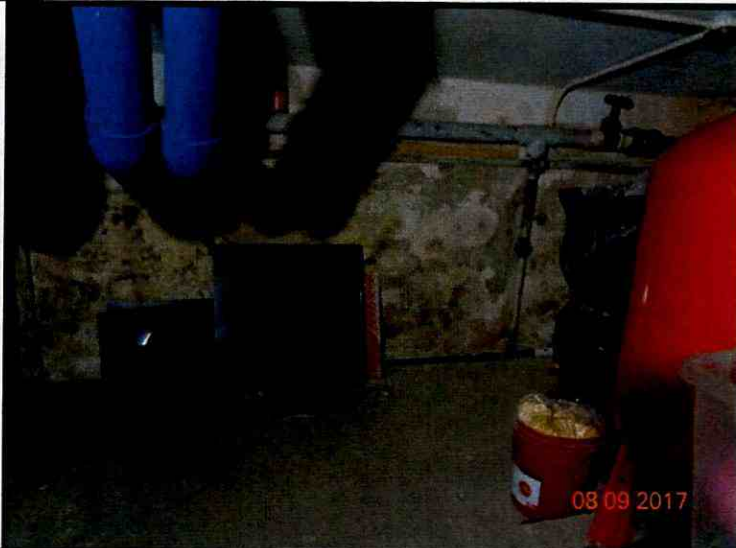
Foto 3. Vista de las humedades en muros de semisotano.
