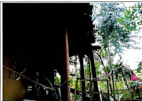
Fotografía 2. Zona de la parte interna del predio con colapsos de cubierta.
