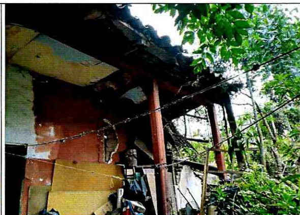
Fotografía 4. Zona de la parte interna del predio con colapsos de cubierta.
