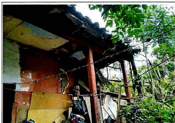
Fotografía 3. Zona de la parte interna del predio con colapsos de cubierta.
