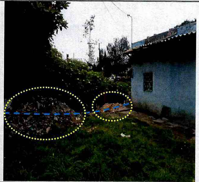
Fotografía 6. Acumulación de escombros en la parte alta del talud de la margen derecha de la quebrada Santa Librada a la altura de la Carrera 13 C Este
