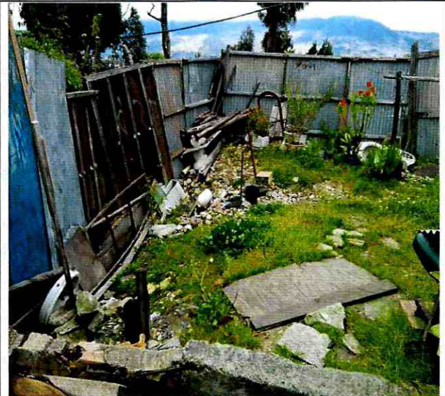
Fotografía 4. Cerramiento en láminas metálicas de la zona de patio de la vivienda ubicada en el predio de la Carrera 13 C Este No. 75 B – 41 Sur, en el Sector Catastral Juan Rey Sur de la Localidad Usme.
