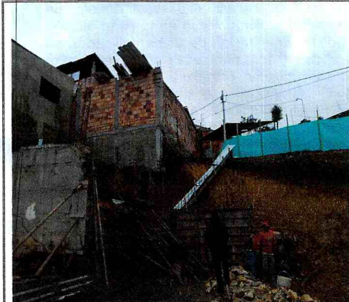
Fotografía 3. Vista de los taludes de corte que se ejecutan en el predio evaluado a la altura del Kilómetro 1 vía Guavio – La Calera, se observa la cimentación en voladizo de la construcción que se desarrolla en la parte alta del talud.
