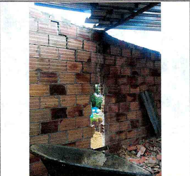
Fotografía 6. Grietas identificadas en muros de cerramiento de la edificación que se construye en la parte alta del predio donde se desarrollan los taludes de corte, el cual se ubica a la altura del Kilómetro 1 vía Guavio – La Calera.
