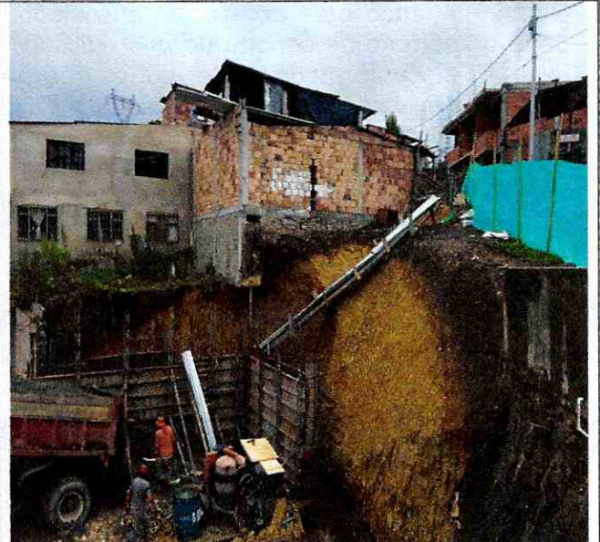
Fotografía 4. Vista de los taludes de corte que se ejecutan en el predio evaluado a la altura del Kilómetro 1 vía Guavio – La Calera, se observa la cimentación en voladizo de la construcción que se desarrolla en la parte alta del talud.
