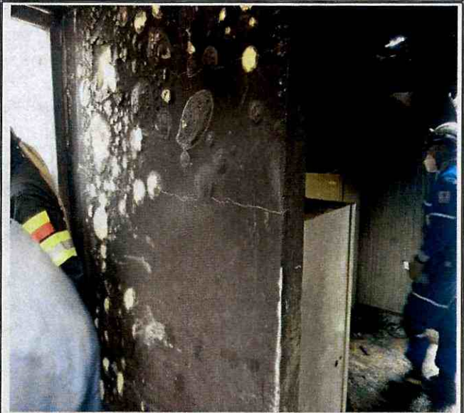
Fotografía 4. Agrietamiento y desprendimiento de pañete en muros del apartamento del tercer nivel del predio de la de la Diagonal 34 A Sur No. 81 A – 06, en el Sector Catastral Maria Paz de la Localidad Kennedy, dadas el choque térmico por las altas temperaturas durante el incendio.
