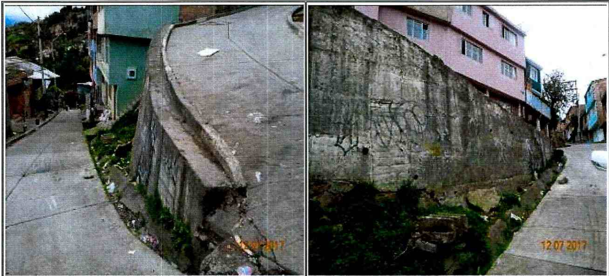
Foto No. 1 y 2. Vista talud de corte vial ubicado en la Carrera 3 a la altura de la Diagonal 163 A del Barrio Urbanización Santa Cecilia Norte Parte Alta de la Localidad de Usaquén
