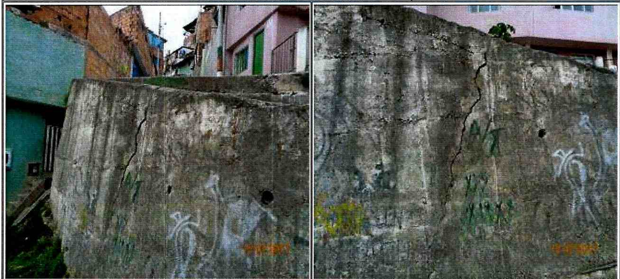
Fotos No. 3 y 4. Grieta tendencia diagonal en muro de contención talud de corte vial ubicado en la Carrera 3 a la altura de la Diagonal 163 A, Barrio Urbanización Santa Cecilia Norte Parte Alta de la Localidad de Usaquén
