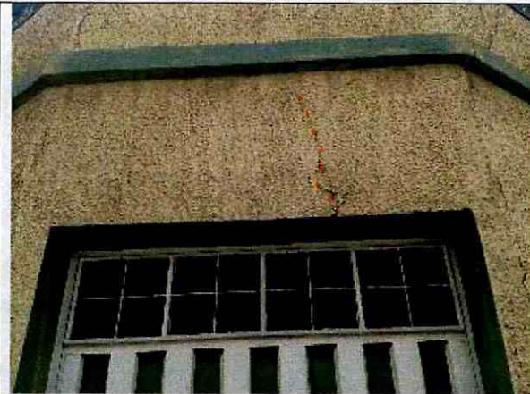
Fotografía 3. Fisura en la parte frontal de la vivienda localizada en Calle 50 B Sur No. 31-96, en el Barrio Samore de la Localidad de Tunjuelito.
