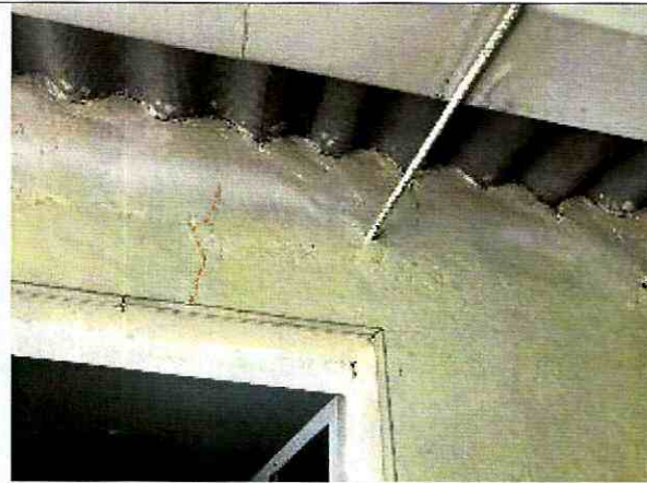
Fotografía 6. Fisuras de 2mm en el marco de una de las puertas de las habitaciones de la vivienda de la Calle 50 B Sur No. 31-96, en el Barrio Samore de la Localidad de Tunjuelito
