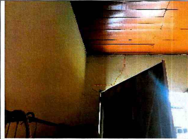
Fotografía 5. Fisuras transversales evidenciadas al interior de la vivienda de la Calle 50 B Sur No. 31-96, en el Barrio Samore de la Localidad de Tunjuelito.
