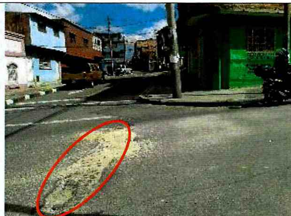
Fotografía 8. Daños en la estructura de pavimento en la intersección de la calle 50B Sur y la Carrera 32, frente a la vivienda evaluada.
