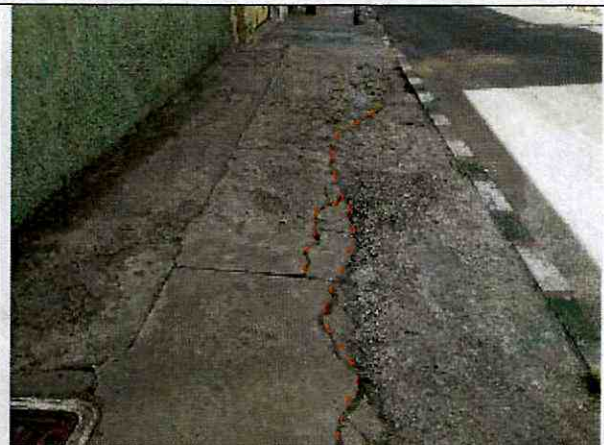
Fotografía 2. Andén frontal de la vivienda localizada en la Calle 50 B Sur No. 31-96, en el Barrio Samore de la Localidad de Tunjuelito. Se observan algunas fisuras longitudinales.
