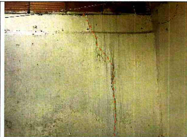
Fotografía 7. Fisuras transversales evidenciadas al interior de la vivienda de la Calle 50 B Sur No. 31-96, en el Barrio Samore de la Localidad de Tunjuelito.
