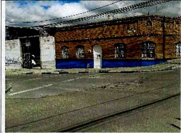
Fotografía 9. Daños en la estructura de pavimento en la intersección de la calle 50B Sur y la Carrera 32, frente a la vivienda evaluada.
