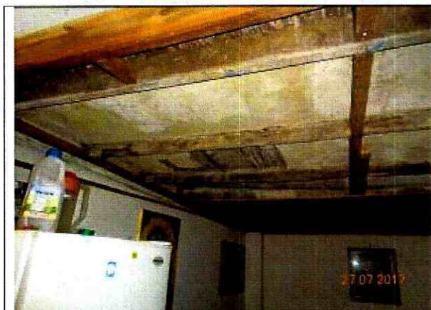
Fotografía 3. Cielo raso retirado en el apartamento del segundo nivel en la zona de la sala
