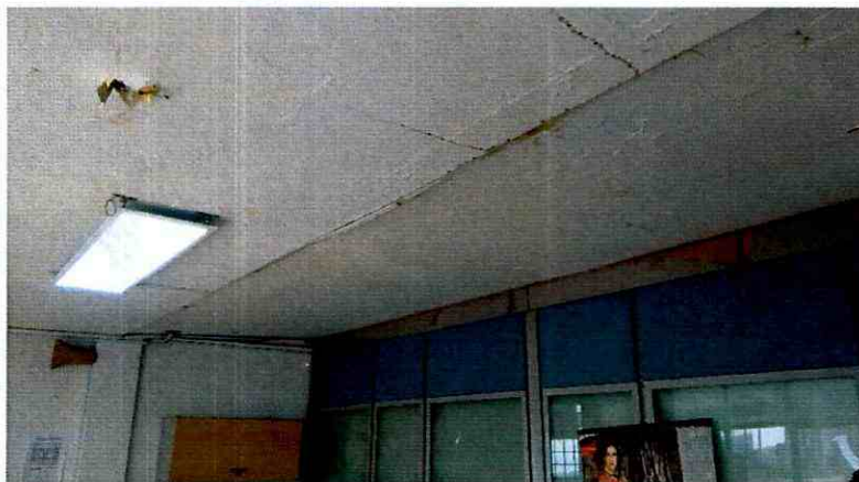
Fotografía 5. Presencia de humedad y desprendimiento de la pintura del cielo raso.
