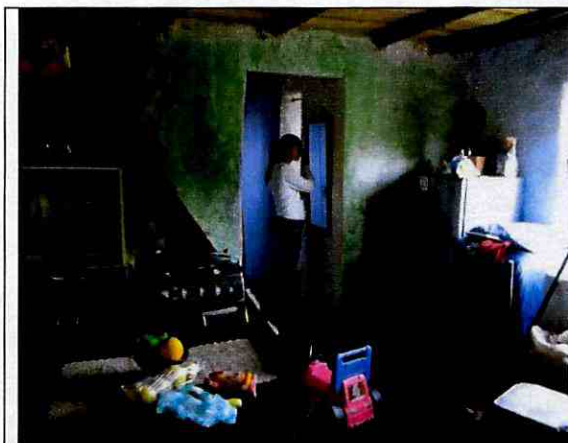
Fotografía 3. Vista de espacio interior de primer nivel de la edificación evaluada, se observa un buen estado de conservación.
