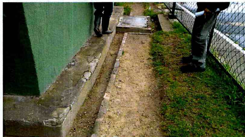
Fotografía 4. Canales de desagüe de agua lluvia que rodean la edificación. Se presenta deterioro por falta de mantenimiento.
