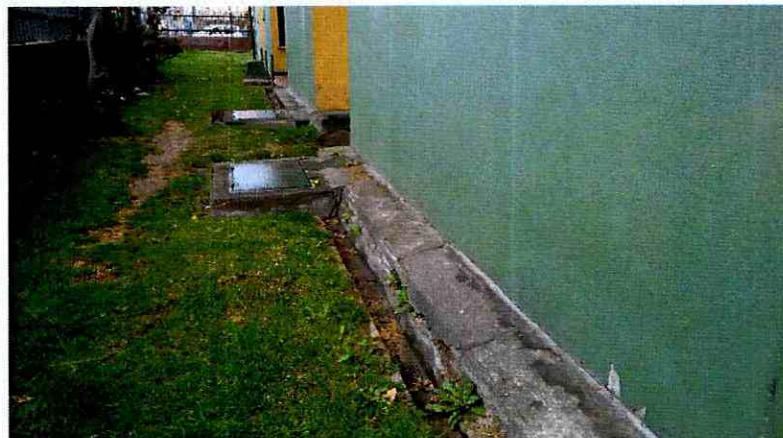
Fotografía 3. Canales de desagüe de agua lluvia que rodean la edificación. Se presenta deterioro por falta de mantenimiento.
