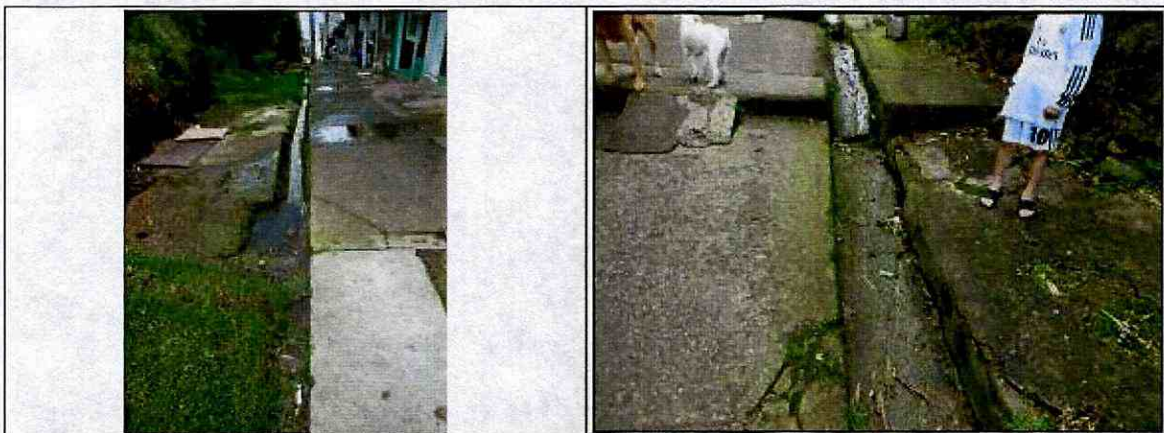
Fotos 3 y 4. Vista de los daños observados en las canales en concreto.
