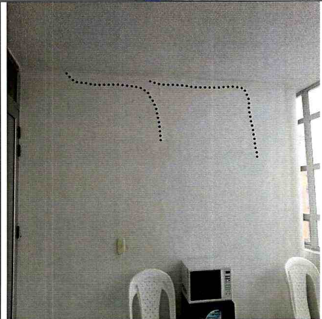
Fotografía 8. Fisuras identificadas en algunos muros divisorios de la edificación social del conjunto residencial Dimonti 2 ubicado en el predio de la Calle 151 No. 109 A – 25.
