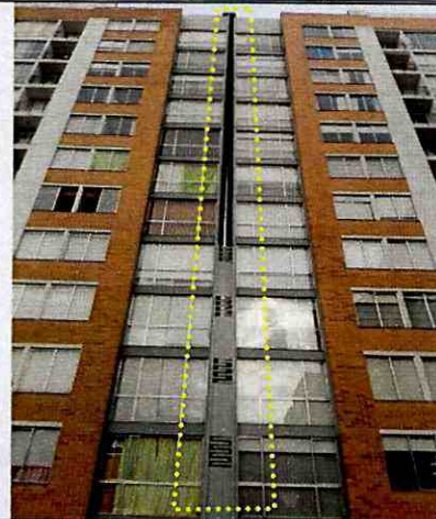
Fotografía 4. Separación entre las torres 2 y 3 del conjunto residencial Dimonti 2 ubicado en el predio de la Calle 151 No. 109 A – 25. Se observa que hacia la parte alta tiende a disminuir.
