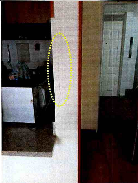
Fotografía 5. Fisuras identificadas en algunos muros divisorios de los apartamentos 1203, 1204, 1004, 603, 601 y 503 de la torre 3, del conjunto residencial Dimonti 2 ubicado en el predio de la Calle 151 No. 109 A – 25.
