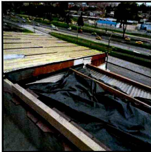
Fotografías 2. Cubierta del apto 601 tapada con polietileno negro en la edificación emplazada en predio de la Calle 26 No 73-36 en la Localidad de Engativá
