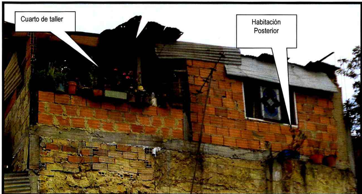
Fotografía 6. Habitación y cuarto de taller, junto al talud evaluado, al interior de predio de la Carrera 45 B No 82 B-11 Sur.
