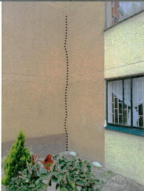
Fotografía 9. Fisuras identificadas en muros de los bloques de apartamentos de la Agrupación de Vivienda Multifamiliares Prado Veraniego, ubicada en el predio de la Carrera 54 B No. 128 – 39, en el Sector Catastral Prado Veraniego Sur de la Localidad Suba.
