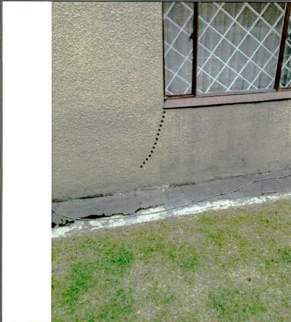
Fotografía 5. Fisuras identificadas en muros de los bloques de apartamentos de la Agrupación de Vivienda Multifamiliares Prado Veraniego, ubicada en el predio de la Carrera 54 B No. 128 – 39, en el Sector Catastral Prado Veraniego Sur de la Localidad Suba.
