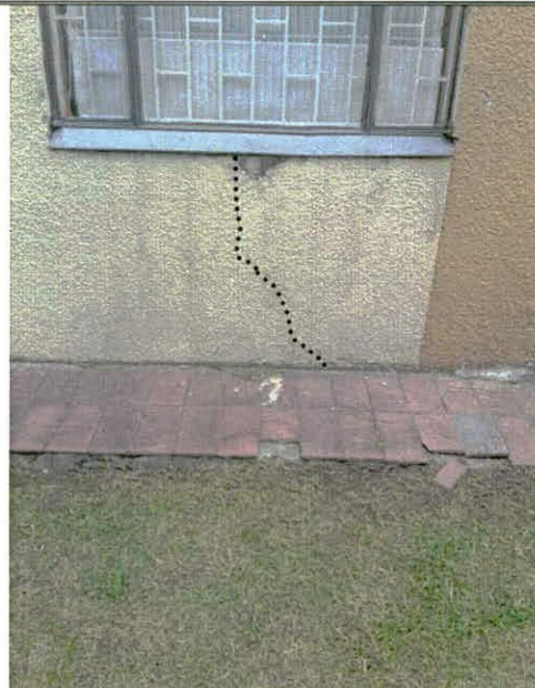
Fotografía 8. Fisuras identificadas en muros de los bloques de apartamentos de la Agrupación de Vivienda Multifamiliares Prado Veraniego, ubicada en el predio de la Carrera 54 B No. 128 – 39, en el Sector Catastral Prado Veraniego Sur de la Localidad Suba.
