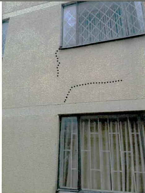
Fotografía 7. Fisuras identificadas en muros de los bloques de apartamentos de la Agrupación de Vivienda Multifamiliares Prado Veraniego, ubicada en el predio de la Carrera 54 B No. 128 – 39, en el Sector Catastral Prado Veraniego Sur de la Localidad Suba.
