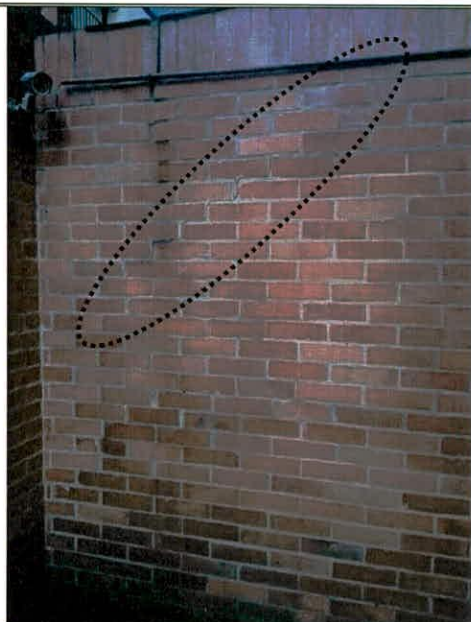
Fotografía 6. Fracturas en muro de cerramiento de la zona posterior del edificio ubicado en el predio de la Calle 103 A No. 11 B – 44, en el Sector Catastral Rincón del Chico de la Localidad Usaquén.
