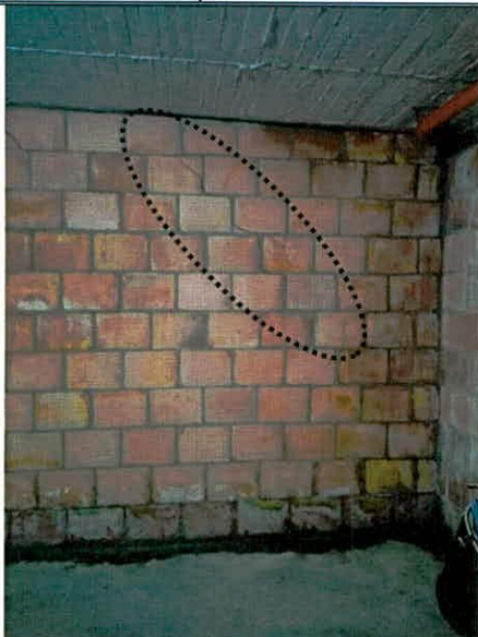
Fotografía 7. Fracturas en muro de cerramiento de la zona posterior del edificio ubicado en el predio de la Calle 103 A No. 11 B – 44, en el Sector Catastral Rincón del Chico de la Localidad Usaquén.
