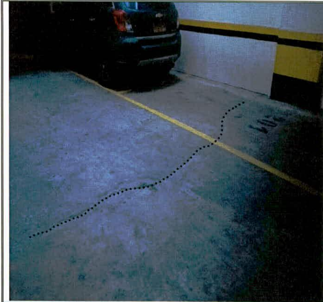
Fotografía 5. Fisuras identificadas en la placa de contrapiso y placa de entrepiso de sótano a primer nivel, en el edificio ubicado en el predio de la Calle 103 A No. 11 B – 44, en el Sector Catastral Rincón del Chico de la Localidad Usaquén.
