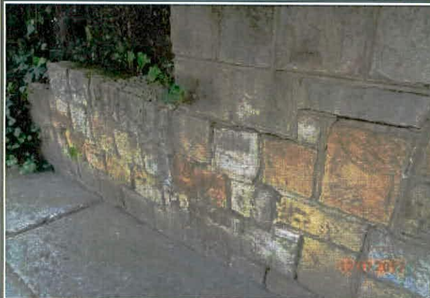
Foto No. 5 y 6. Daños en muro en piedra pegada costado sur del predio de la Carrera 4 A No. 57 - 02
