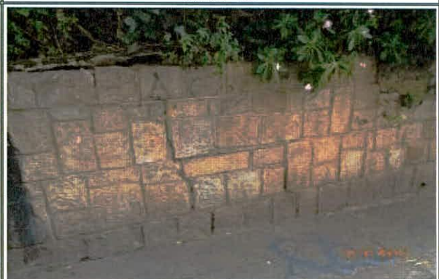
Foto No. 4. Daños en muro en piedra pegada Costado Occidental
