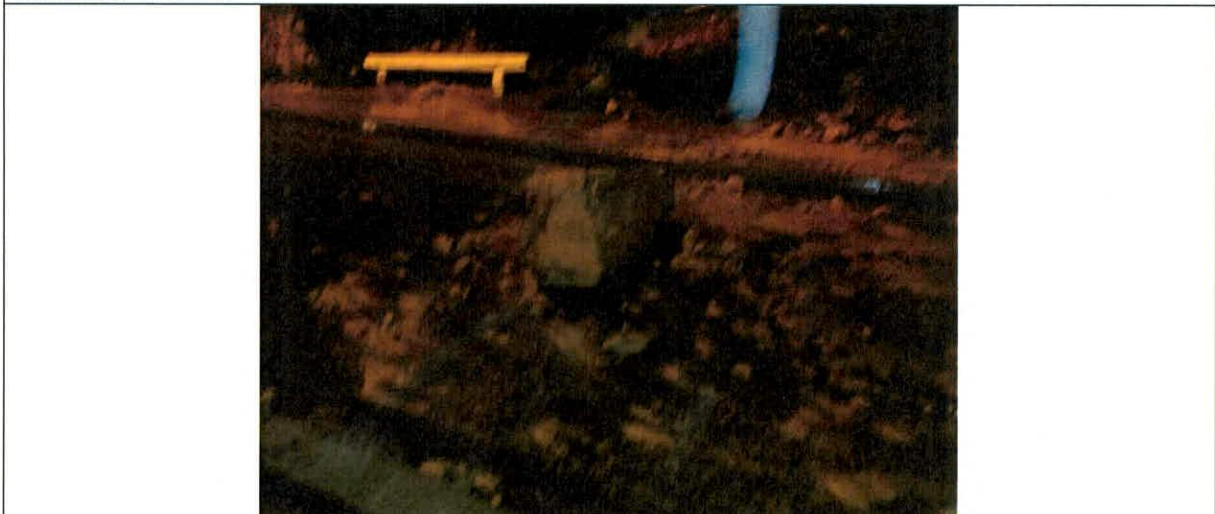
Foto 2: Se evidencia el desprendimientos de los fragmentos rocosos sobre la Calle 65 D Sur, en los predios con nomenclatura en la Calle 65 D Sur N° 6B – 56/62/66/70/74.
