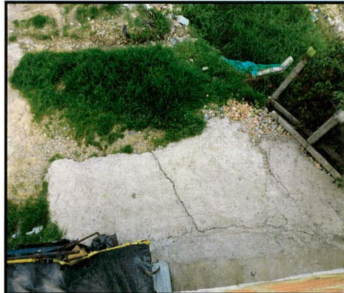
Fotografía 3 .Partición de la placa de concreto frente a la entrada a la vivienda evaluada.
