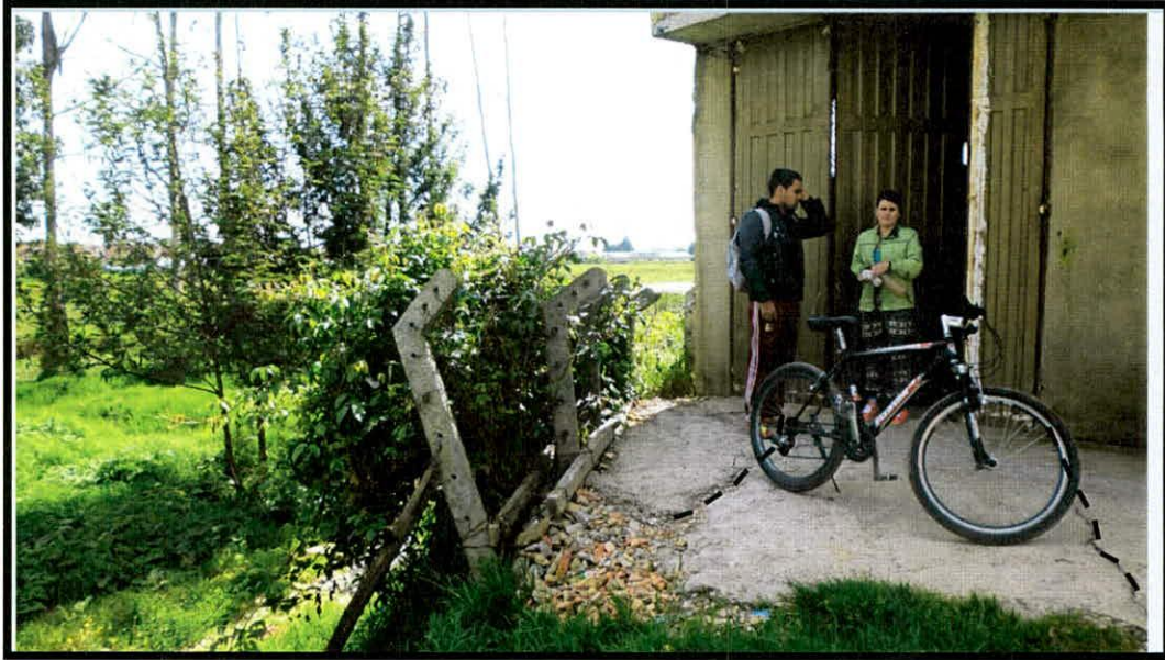
Fotografía 2 .Partición de la placa de concreto frente a la entrada a la vivienda evaluada.
