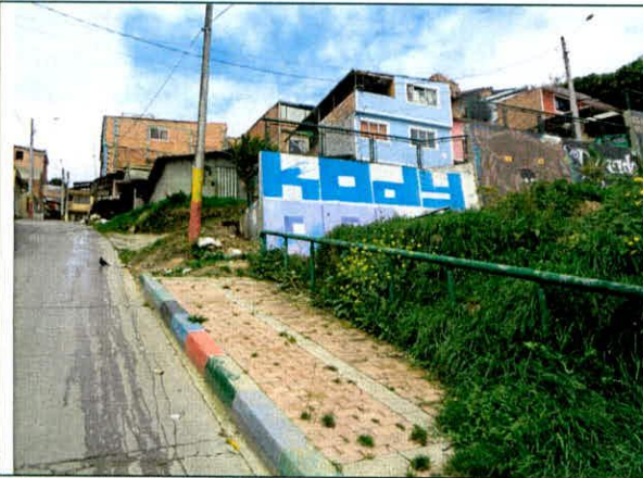
Fotografía 5. Calle 2 F Bis Sur, se observan algunas grietas
