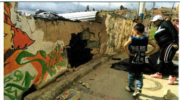
Fotografía 2. Muro que recibe el impacto, ubicado en el costado oriental del predio. Se evidencia pérdida de verticalidad y colapso parcial
