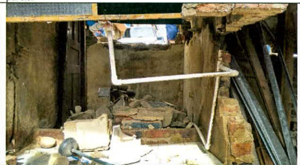
Fotografía 4. El muro colapsa hacia el interior de la vivienda afectando la zona del baño.
