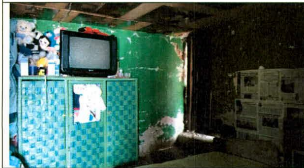
Fotografía 3. Muro de la habitación con daños, se evidencian grietas en la parte superior del muro
