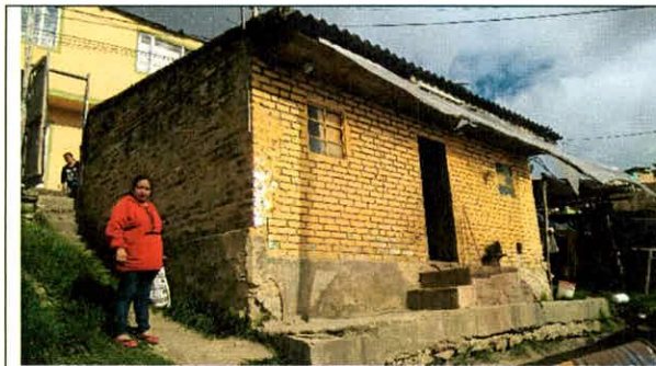
Fotografía 1. Vista general de la edificación que recibe el impacto vehicular. Tomada desde el interior del lote
