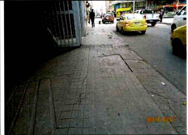
Fotografía 8. Fisuras en los andenes de la carrera 5 costado oriental.
