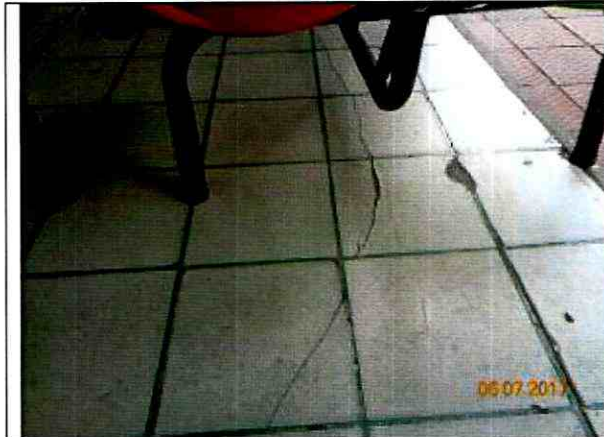
Fotografía 7. Fisura en la entrada del local comercial del predio de la carrera 5 No. 19 – 36.
