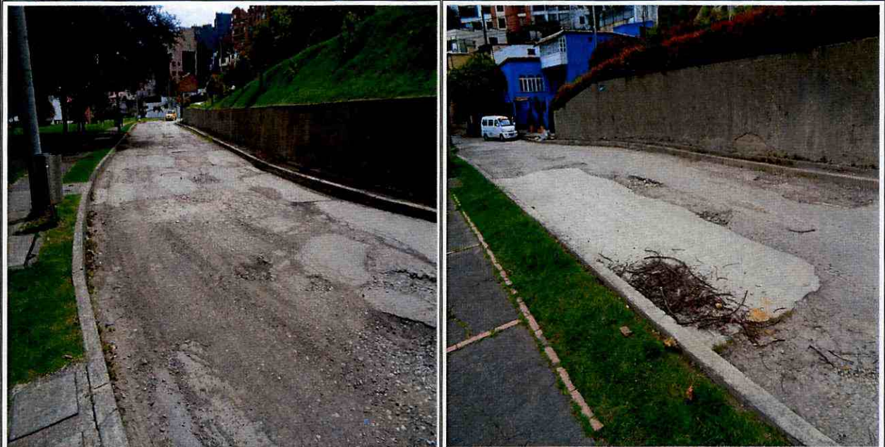
Foto No. 8 y 9. Daños en la vía de acceso principal. Carrera 1 B
