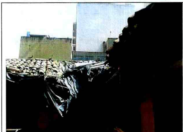
Fotografía 3. Daños en la cubierta costado oriental de la edificación del predio de la Calle 16 No. 7 – 78.
