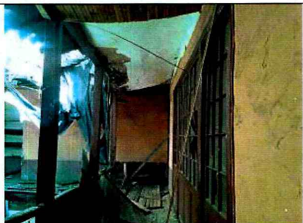
Fotografía 4. Daños ocasionados posiblemente por la pérdida de la cubierta en el costado oriental de la edificación de la Calle 16 No. 7 – 78.
