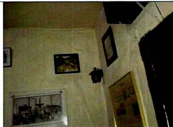
Fotografía 11. Afectaciones en las paredes pertenecientes al salón del costado oriental del Café San Moriz, que se ubica en el primer nivel de la edificación del predio de la Calle 16 No. 7 – 78.
