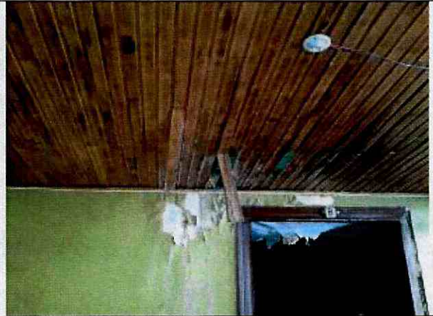
Fotografía 6. Pérdida parcial del cielo raso y parte del pañete en el segundo nivel de la edificación de la Calle 16 No. 7 – 78.
