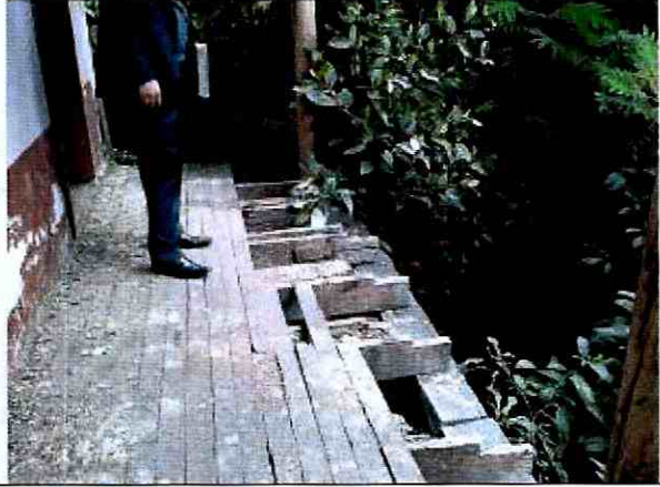
Fotografía 10. D Daños en entrepisos en el costado sur de la edificación de la Calle 16 No. 7 – 78.
