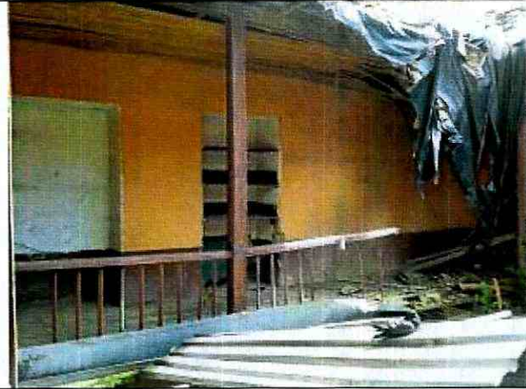
Fotografía 9. Daños en entrepisos de la edificación de la Calle 16 No. 7 – 78.
