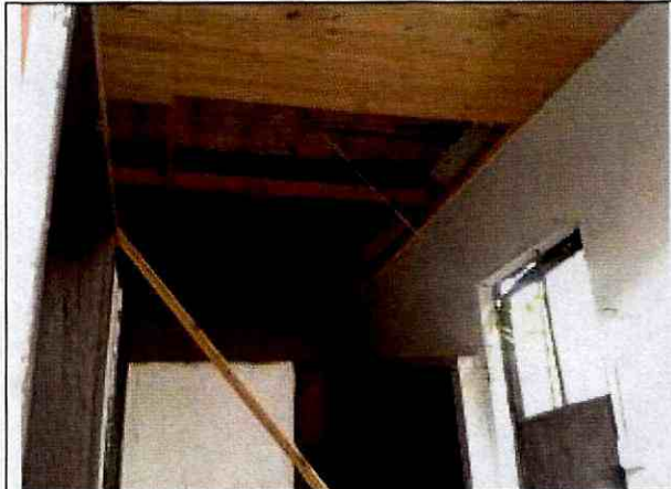
Fotografía 5. Pérdida parcial del cielo raso en el segundo nivel de la edificación de la Calle 16 No. 7 – 78.
