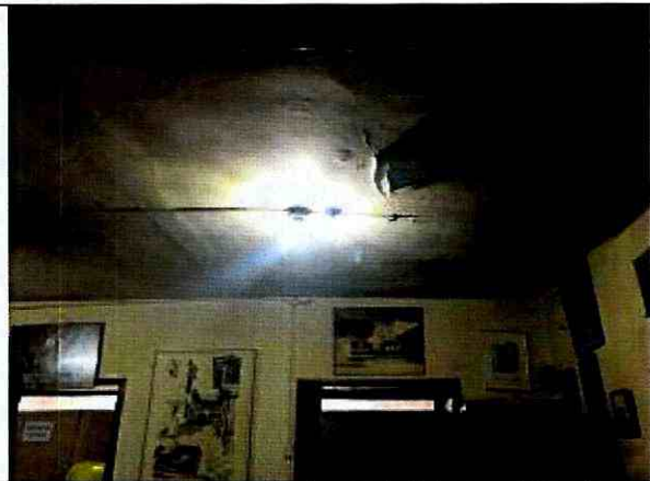
Fotografía 12. Abombamiento en el cielo raso del salón del costado oriental del Café San Moriz que se ubica en el primer nivel de la edificación del predio de la Calle 16 No. 7 – 78.
