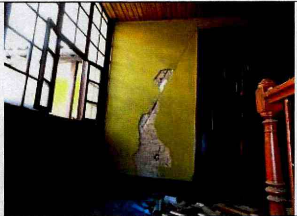
Fotografía 8. Desprendimiento parcial del pañete en el segundo nivel de la edificación de la Calle 16 No. 7 – 78.
