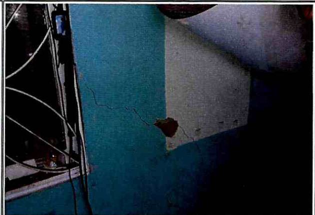
Foto No. 2. Grieta tendencia diagonal en muro divisorio de la vivienda emplazada en el predio de la Carrera 92 No.72-95
