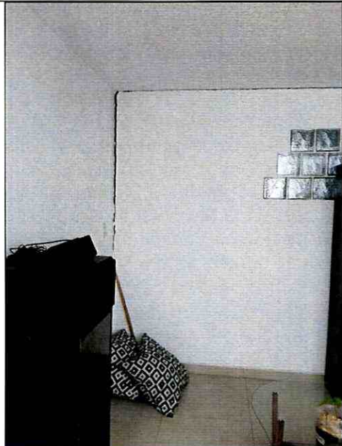
Fotografía 4. Separación entre muros del primer nivel de la edificación emplazada en el predio de la Calle 76 No. 15 – 17, en el Sector Catastral Porciúncula de la Localidad Chapinero.
