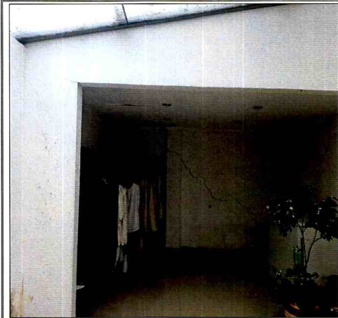
Fotografía 3. Grietas y fisuras identificadas en muros del primer nivel de la edificación emplazada en el predio de la Calle 76 No. 15 – 17, en el Sector Catastral Porciúncula de la Localidad Chapinero.
