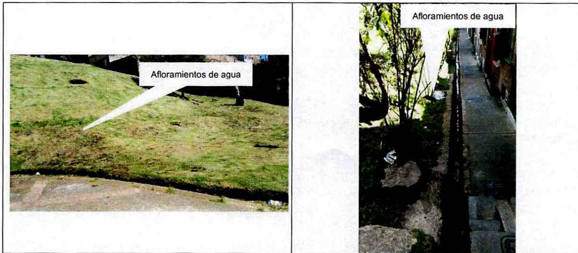
Fotografía 5 y Fotografía 6. Sectores con afloramientos de agua en la zona verde ubicada en la CI 48 B Bis Sur No. 14 A -30, en el Barrio El Pinar de la Localidad San Cristóbal
