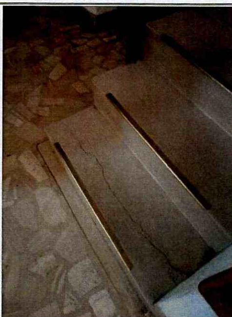
Fotografía 8. Fisuras identificadas en escaleras del edificio Cristales II, ubicado en el predio de la Calle 116 No. 9 – 46, en el Sector Catastral Santa Bárbara Central de la Localidad Usaquén.
