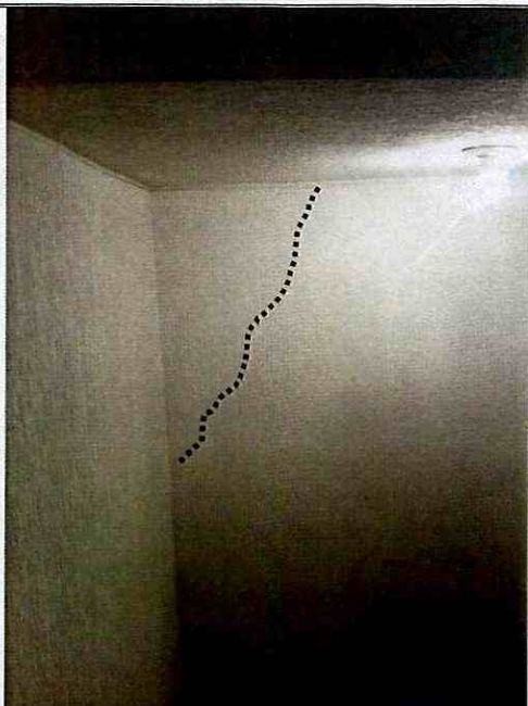
Fotografía 7. Fisuras identificadas en muros de zona comunes del edificio Cristales II, ubicado en el predio de la Calle 116 No. 9 – 46, en el Sector Catastral Santa Bárbara Central de la Localidad Usaquén.
