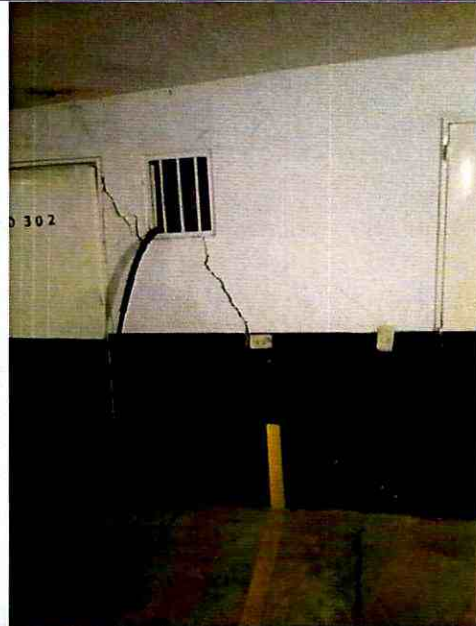
Fotografía 4. Grietas identificadas en muros de cerramiento del costado norte del edificio Cristales II, ubicado en el predio de la Calle 116 No. 9 – 46.
