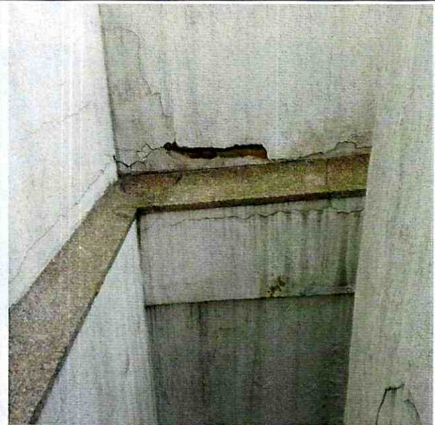
Fotografía 6. Grietas identificadas en muros de cerramiento del costado norte del edificio Cristales II, ubicado en el predio de la Calle 116 No. 9 – 46.
