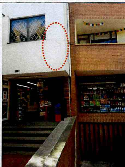
Fotografía 10. Fisuras identificadas en muros de fachada del edificio Cristales II, ubicado en el predio de la Calle 116 No. 9 – 46, en el Sector Catastral Santa Bárbara Central de la Localidad Usaquén.
