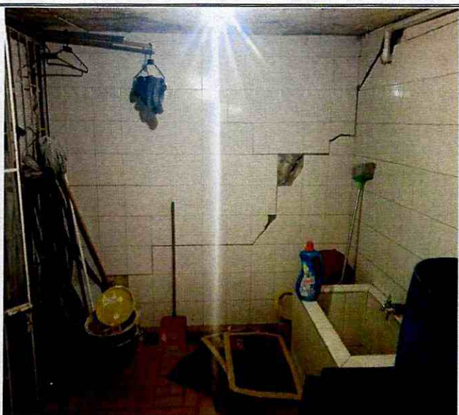
Fotografía 9. Grietas identificadas en muros de cerramiento del costado sur en sótano, específicamente en cuarto de aseo del edificio Cristales II, ubicado en el predio de la Calle 116 No. 9 – 46.
