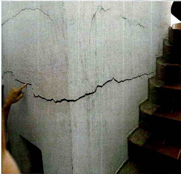
Fotografía 5. Grietas identificadas en muros de cerramiento del costado norte del edificio Cristales II, ubicado en el predio de la Calle 116 No. 9 – 46.
