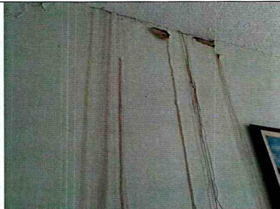
Fotografía 6. Daños en las paredes como producto de las infiltraciones de agua provenientes de la cubierta.
