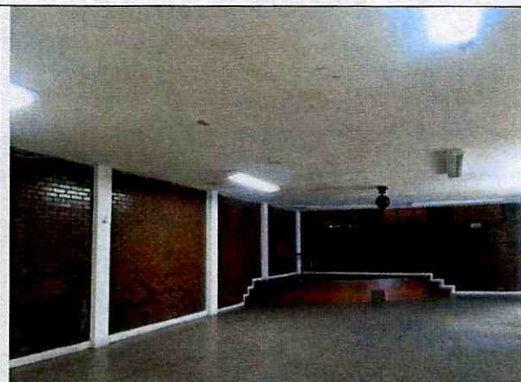
Fotografía 2. Vista interior del salón comunal, se evidencia abombamiento del cielo raso como causa de las infiltraciones de agua proveniente de la cubierta.
