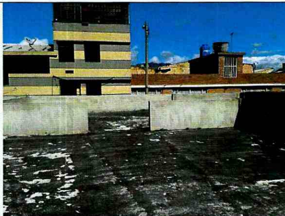
Fotografía 8. Deficiente sistema de Impermeabilización de la cubierta en concreto.
