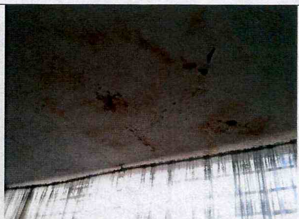
Fotografía 4. Daños en el cielo raso de la estructura como producto de las infiltraciones de agua desde la cubierta.
