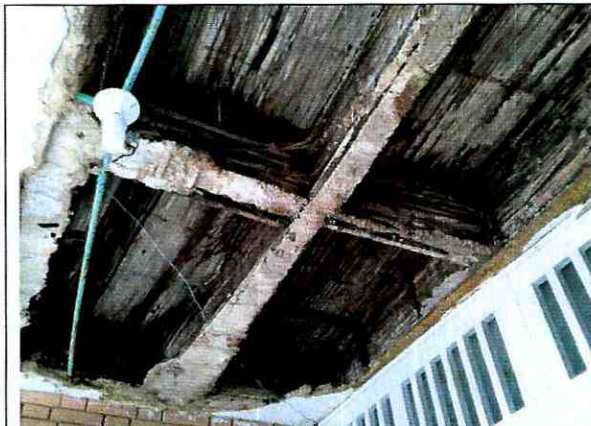
Fotografía 5. Desprendimiento del cielo raso en la entrada principal del Salón comunal del barrio San Eusebio.
