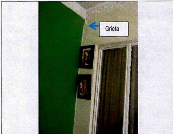
Fotografía 5. Vista de vértice interior entre muros (donde se observa grieta vertical).
