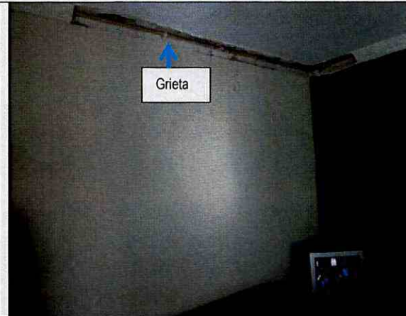
Fotografía 6. Vista de vértice interior entre muro y techo (donde se observa grieta horizontal y desprendimiento de acabado y tubería interna de gas).
