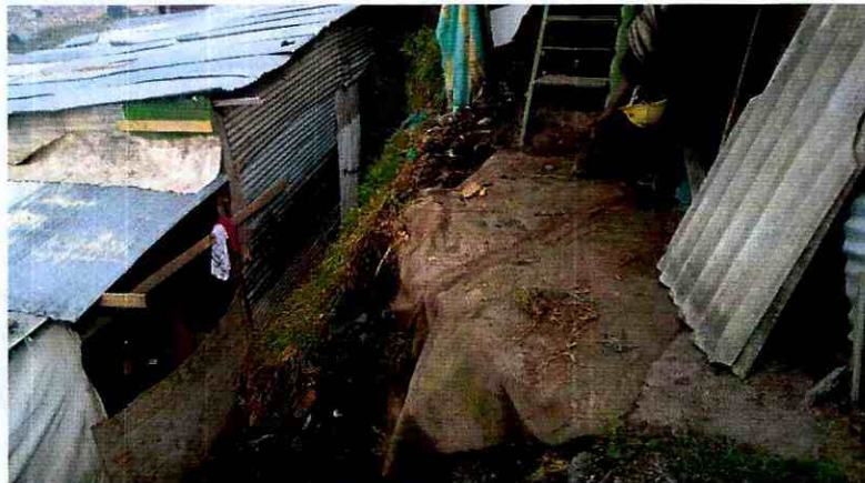
Fotografía 5. Desprendimiento del talud y desconfinamiento del suelo de soporte de la vivienda ubicada en la Calle 71A Sur # 22 – 09 (Predio 2, figura1)
