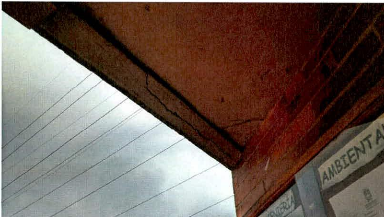
Fotografía 4. Fisura en elemento de borde la placa de cubierta.
