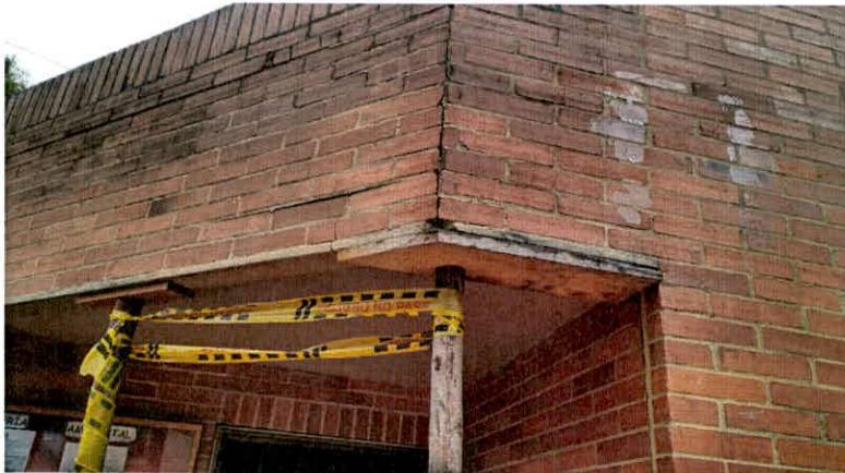
Fotografía 3. Fisuras con tendencia horizontal
