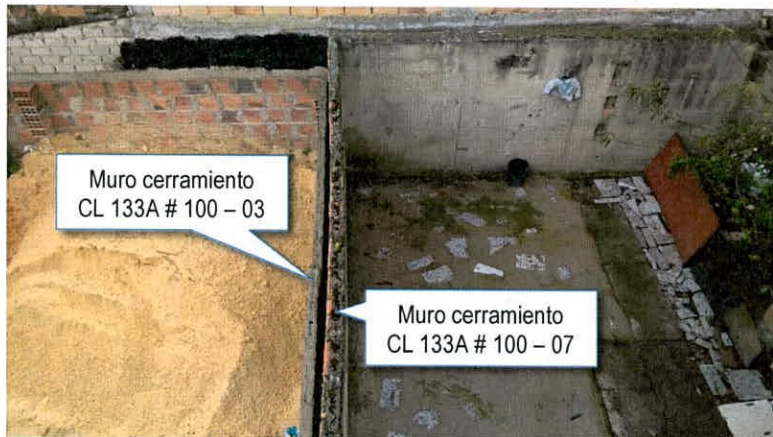
Fotografía 3. Material de la construcción ubicado en el predio de la Calle 133A # 100 – 03.
