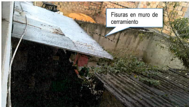
Fotografía 6. Muro de cerramiento con fisuras diagonales y escalonadas. Predio de la Calle 133A # 100 – 07
