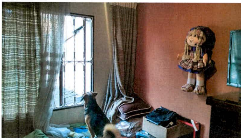
Fotografía 4. Muros interiores sin grietas ni fisuras en el inmueble ubicado en la Calle 133A # 100 – 07.
