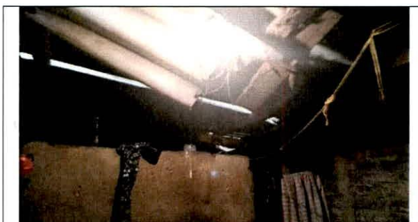
Fotografía No. 1. Vista de afectación en cubierta al interior de la vivienda
