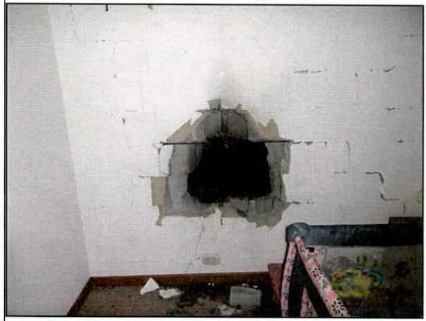
Foto 6. Vista de los daños presentados en la habitación aledaña al Apartamento 301, donde se presentó la explosión y posterior conflagración.
