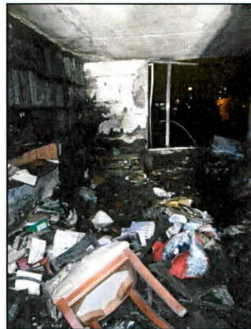
Foto 2. Vista de los daños al interior del Apartamento 301 de la Torre 6, donde se presentó la explosión y posterior conflagración.
