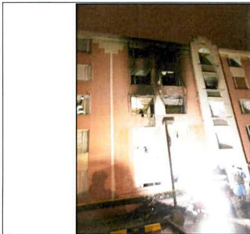
Foto 1. Vista de la Torre 6, en la cual se presentó la explosión y posterior conflagración, localizada al interior del Conjunto Residencial Santa Helena de Baviera III.
