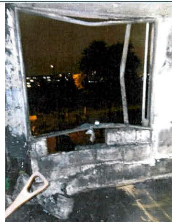
Foto 4. Vista de los daños al interior del Apartamento 301 de la Torre 6, donde se presentó la explosión y posterior conflagración.
