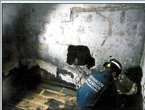
Foto 3. Vista de los daños al interior del Apartamento 301 de la Torre 6, donde se presentó la explosión y posterior conflagración.
